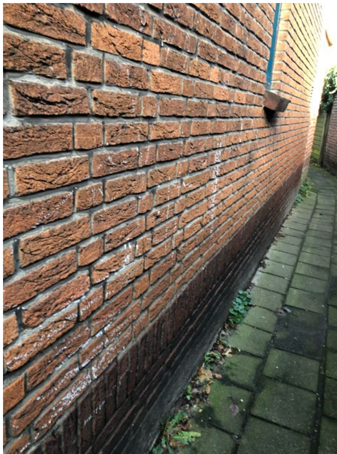
32. Vorstschade baksteen door optrekkend vocht
